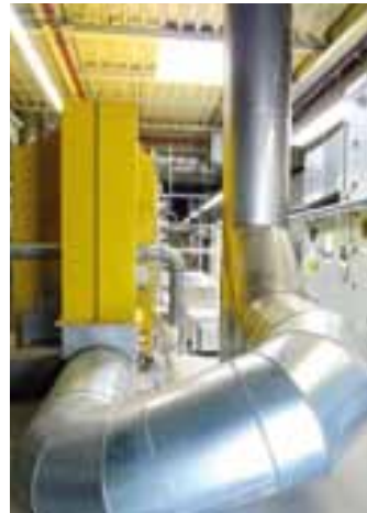
Eindrucksvoll ist auch die Haustechnikzentrale: die Verrohrung zwischen TRA und Kamin
